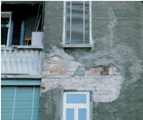
Fatada degradata a cladirii care are nevoie de reparatii
