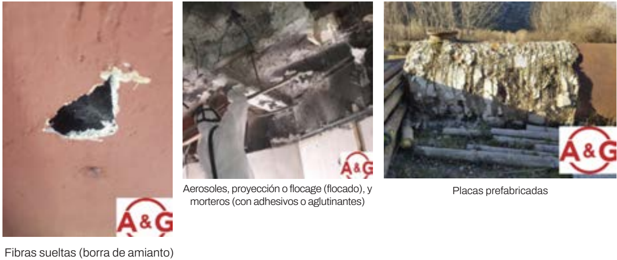
Figura 4. Diferentes configuraciones de amianto friable
