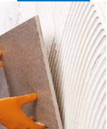
Colocación de baldosa de bicocción de gran formato en pared de arriba hacia abajo
