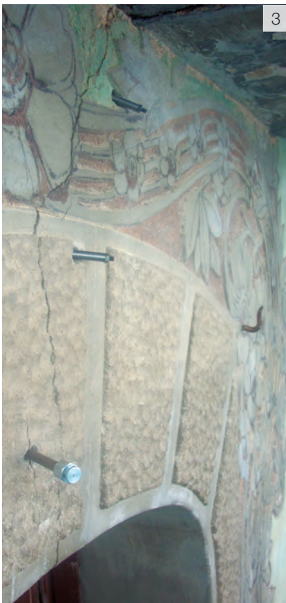
Fotos 3 y 4: Detalles de afectaciones en la fachada antes de su rehabilitación.
