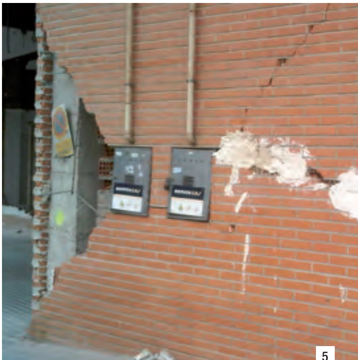
Foto 5. Muro exterior fuertemente dañado.
