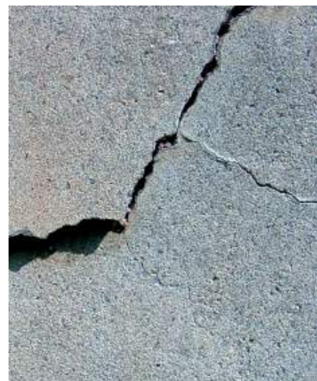
Рис. 16. Трещина в бетоне
