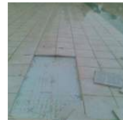
Рисунок 5.1 – Плитка, отделившаяся от основания из-за сдавливающих напряжений
