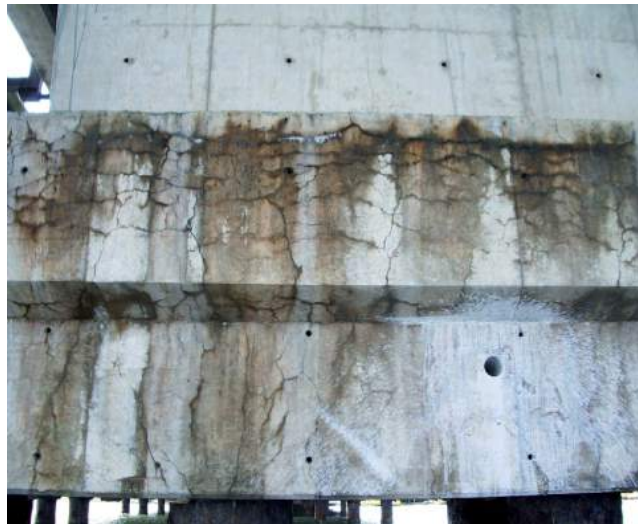
Рис. 11. Разрушение из-за реакции взаимодействия щелочей цемента с заполнителями бетона
