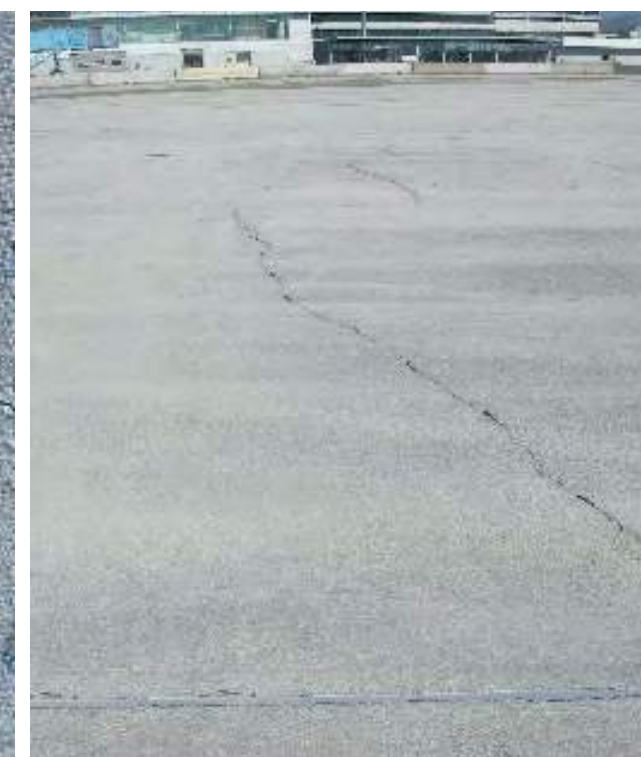
Рис. 17. Трещина в бетонной плите
