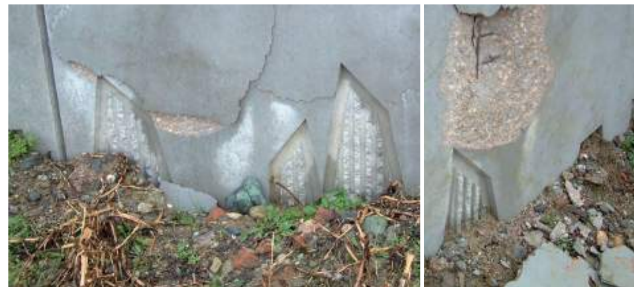
Рис. 14. Разрушение, вызванное циклами замораживания/оттаивания
