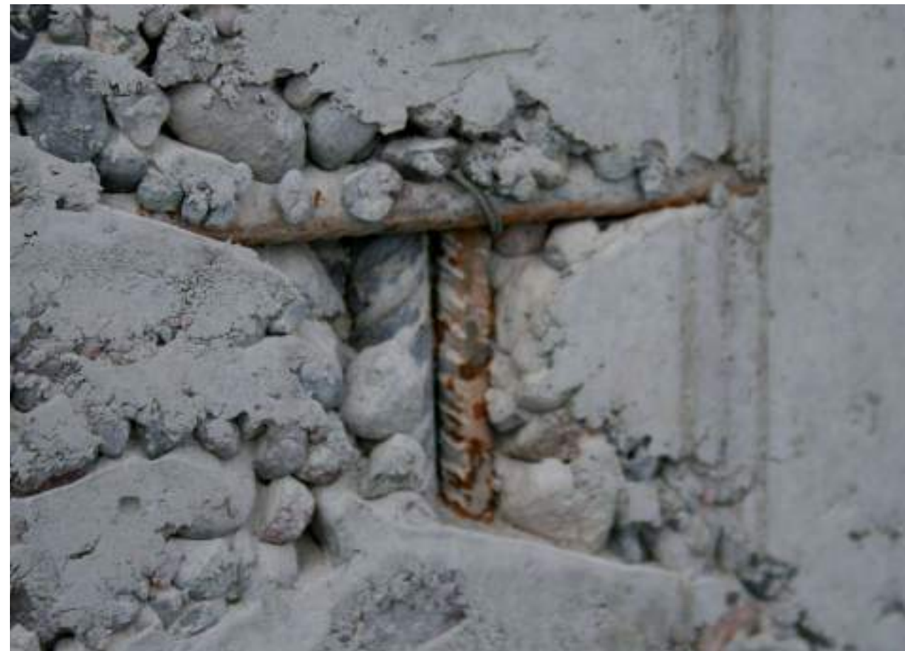
Рис. 22. Открытые арматурные стержни в бетоне
