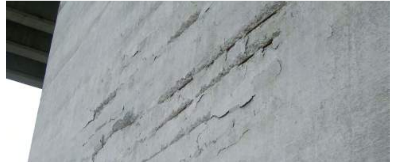
Рис. 4. Разрушение сооружения вследствие коррозии арматурных стержней
