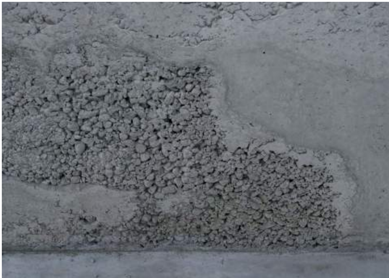
Рис. 21. Разделение заполнителей в бетоне
