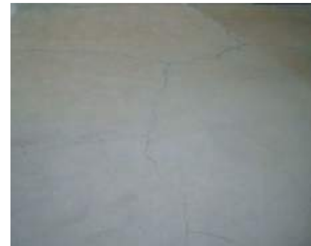
Трещины на поверхности стяжки
