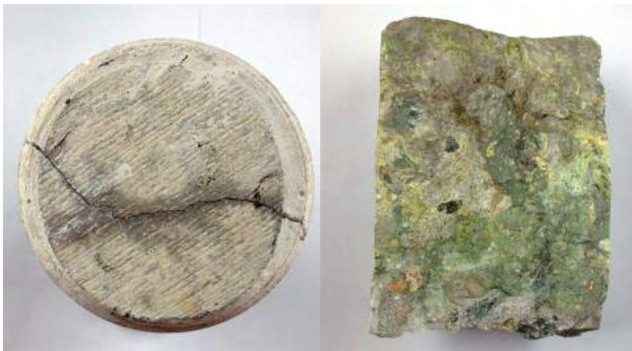
Рис. 12. Образец, взятый из сердцевины бетона, разрушенной структуры
