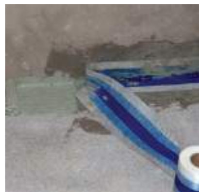
Рисунок 3.5 – Гидроизоляция и герметизация плиточных швов между горизонтальной и вертикальной поверхностями с помощью ленты MAPEBAND
