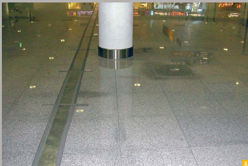
Slika 6: Nepravilna izbira fugirne mase na zaključni oblogi iz kamna povzroči močno razbarvanje na robovih
