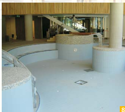
Slika 8: Keramične ploščice v bazenu lepljene na cementno lepilo Keraflex razreda C2, zafugirano s cementno fugirno maso Ultracolor Plus
