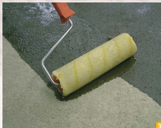
Slika 3: Izgled tlaka z izvedenim sistemom reakcijskih smol
