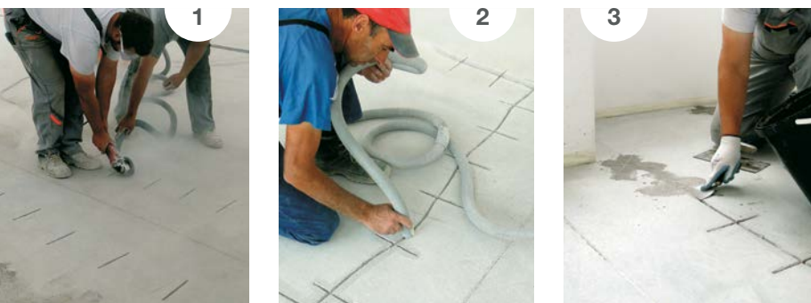
SLIKE 1, 2 in 3: Zarezovanje, čiščenje in šivanje razpok z dvokomponentno epoksidno smolo PRIMER MF.
