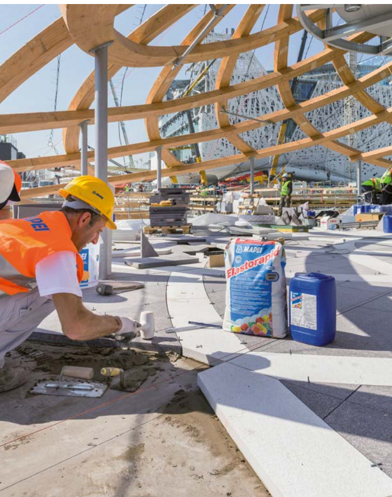
ZGORAJ: Temelje so obložili z naravnim kamnom, ki so ga polagali s cementnim lepilom ELASTORAPID, za fugiranje pa so uporabili ULTRACOLOR PLUS.
