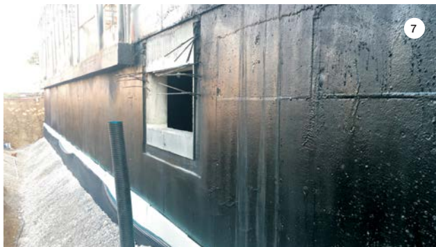
SLIKA 6: Strojna vgradnja dvokomponentne, bitumske hidroizolacije PLASTIMUL 2K REACTIVE, na predhodno naneseni in posušeni temeljni premaz PLASTIMUL PRIMER SB.
