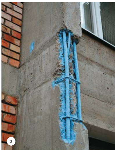
SLIKA 1: Poškodbe armature in betona na stebri pred začetkom izvajanja sanacije.
