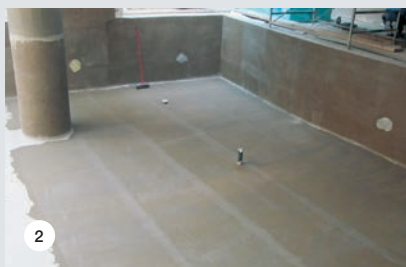
SLIKA 1 in 2: Lepljenje keramičnih ploščic na MAPELASTIC na balkonu obmorskega hotela ter tesnilni sistem v bazenu.
