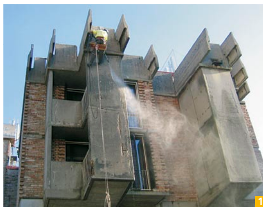
Slika 1: Čiščenje betonskih površin pred sanacijo z vodo pod pritiskom po alpinistični metodi
