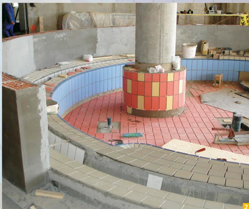
Slika 1: Za izravnave bazenskega dna se je uporabil Mapecem Pronto in Planitop 400, na katerega se je izvedel hidroizolacijski sistem Mapelastic Slika 2: Keramične ploščice, zalepljene s cementnim lepilom Keraflex
