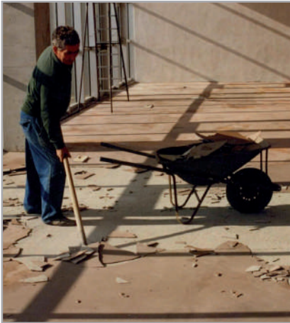
Рис. 8.10. Порушення адгезії між ULTRAPLAN та стяжкою, не очищеною від цементного молочка
