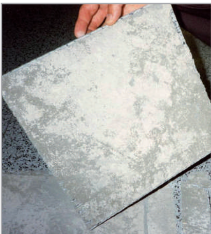
Рис. 3.4. Відшарування керамічної плитки від крихкої стяжки
