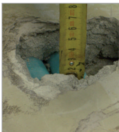
Рис. 8.6. Недостатня товщина стяжки над трубопроводом (< 30 мм)
