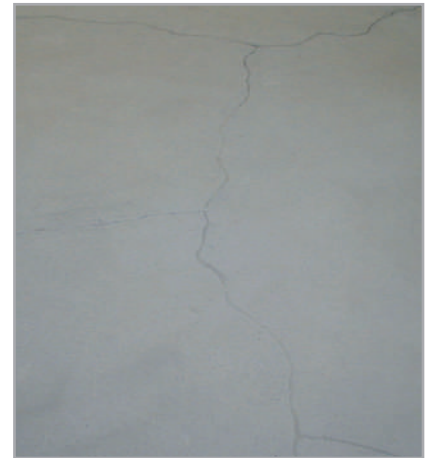
Рис. 8.1. Стяжка з тріщинами
