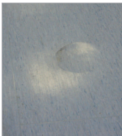
Рис. 8.5. Просідання стяжки в місцях пролягання трубопроводів
