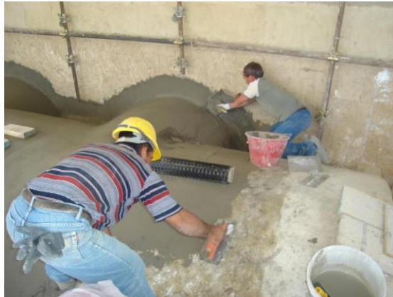
Рисунок 26 – Нанесення на конструкцію першого шару Planitop HDM Maxi або Planitop HDM Restauro
