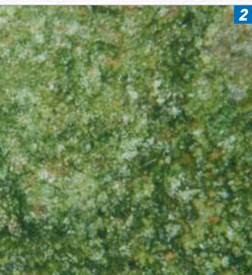
2. Dettaglio di parete esterna con alghe
