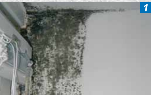
1. Parete interna con muffa
