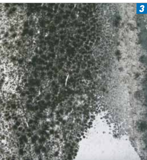
3. Dettaglio di parete esterna con muffa
