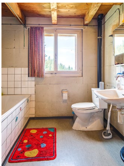
So sah das Badezimmer vor der Instandsetzung aus. Voici la salle de bains telle qu'elle était avant la rénovation.
