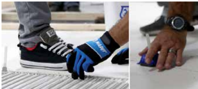
Exemple de carreaux calibrés installés sur des carreaux existants à l'aide d'un système de nivellement mécanique lors de travaux
