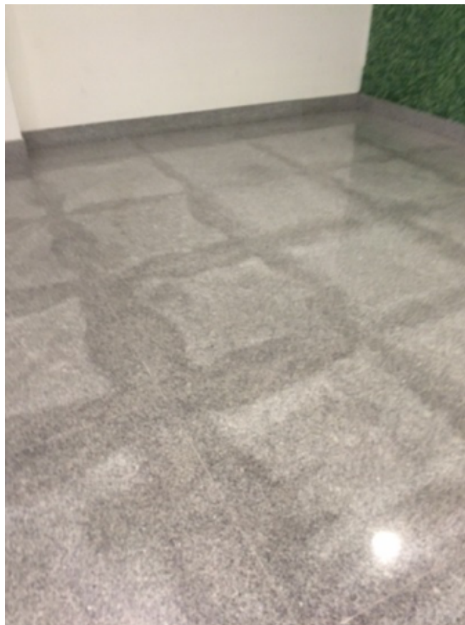
L'effet « d'encadrement » inesthétique sur un sol de granit aurait pu être évité à l'aide de matériaux de pose époxydes ou en scellant les six côtés des carreaux avant l'installation.
