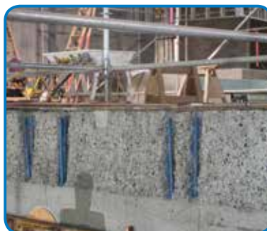
Protección contra corrosión
