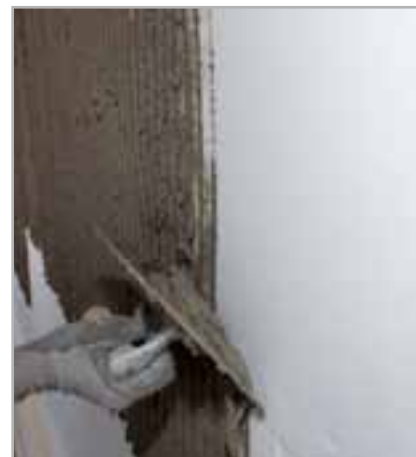
Fig. 5.7 – Aplicación de PLANITOP HDM MAXI sobre la superficie de los paneles de EPS
