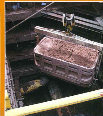
Eliminación de la tierra excavada de la boca sur de la galería. En la foto, elevación del pozo de una vagoneta llena de material, acondicionado con POLYFOAMER FP
