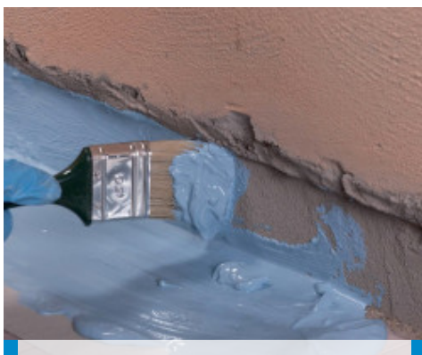
Aplicación con brocha de Mapelastic AquaDefense en la unión pared/piso, antes de la aplicación de Mapeband
