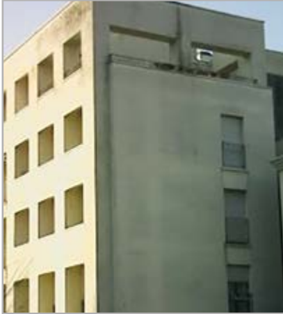
Edifício sem isolamento térmico pelo exterior onde se destacam as pontes térmicas da estrutura (vigas e pilares). Os tamponamentos em alvenaria apresentam agressões biológicas por serem mais frios
