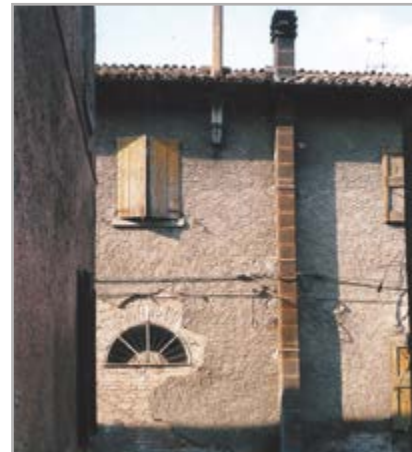
Fig. 6.1 - Edifício em alvenaria afetada por humidade ascendente capilar
