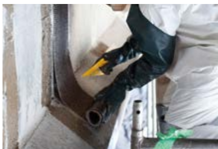
Aplicação de tecido em fibra de carbono. Application of carbon fibre fabric.
