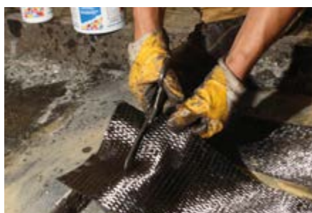
Corte de tecido de fibra de carbono à medida na obra. Cutting carbon fibre fabric to size on site.
