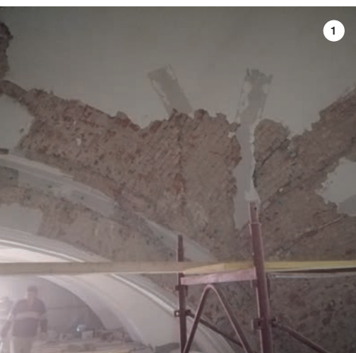
SLIKA 1: Prije sanacije bila su vidljiva znatna konstrukcijska oštećenja na zidanoj konstrukciji svoda.
