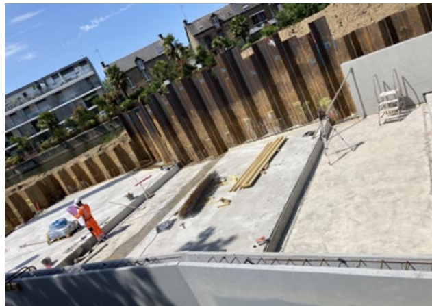
▲ Dallage béton de la nouvelle piste de navigation avant sa mise en eau.
