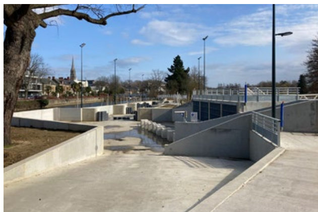
▼ La centrale de Rennes située à quelques kilomètres de Cesson-Sévigné a fourni l'ensemble du béton prêt à l'emploi.
