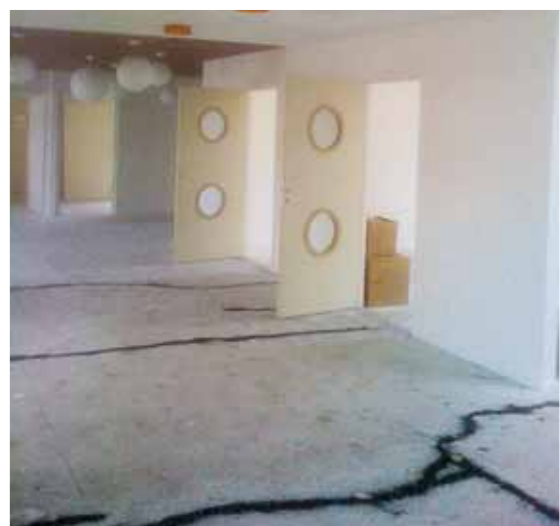
Les fissures ont préalablement été réparées avec Eporip
