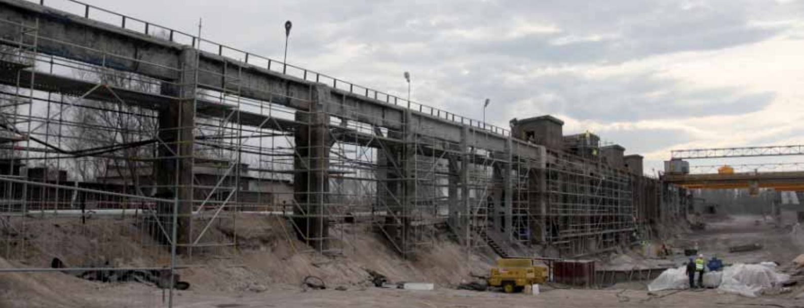
Widok konstrukcji żelbetowej w strefie zrzutu żużla przed renowacją.
