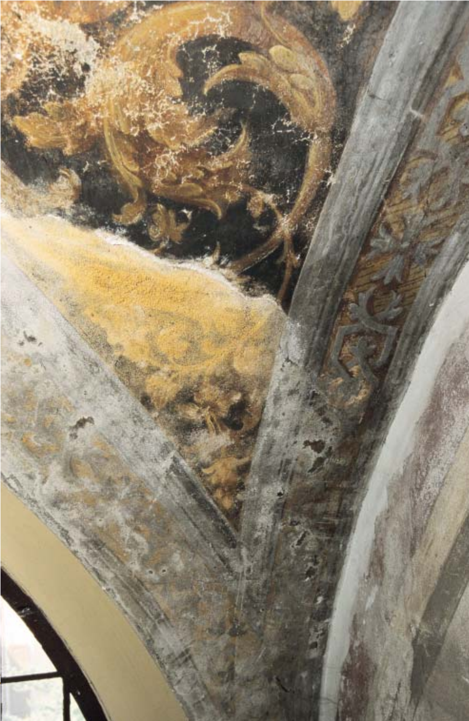
Tonachino a grana più grossa sovrapposto all'intonaco originale, prima dell'intervento.
