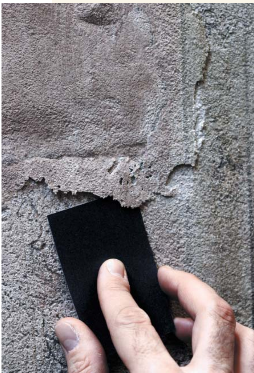
Prelievo di un campione di tonachino in fase di distacco.
