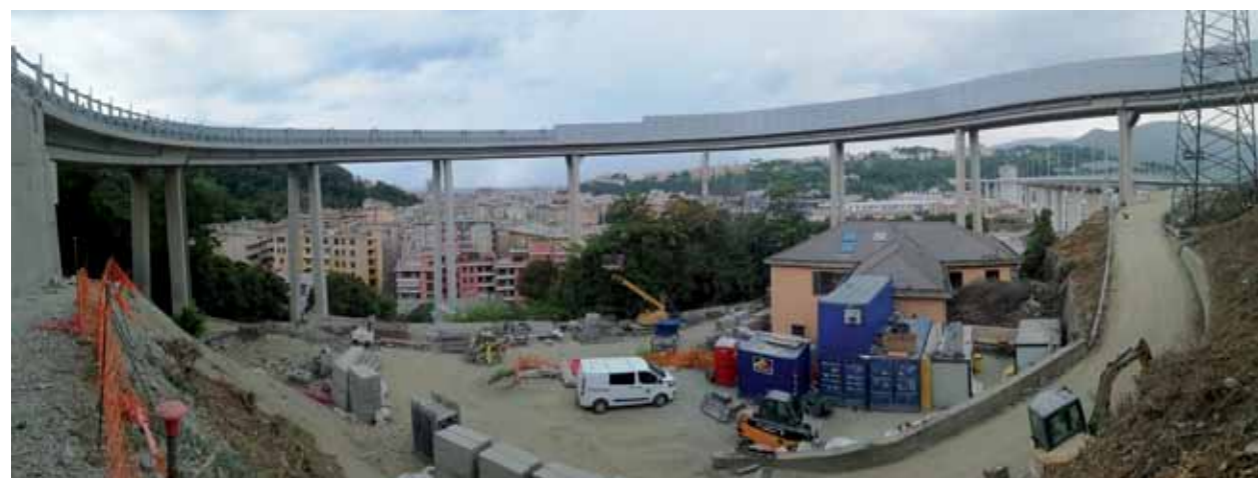
I lavori di ripristino hanno interessato l'impalcato sia all'intradosso che all'estradosso. Sono stati utilizzati diversi prodotti tra cui la malta tissotropica fibrorinforzata MAPEGROUT EASY FLOW e i betoncini colabili MAPEGROUT GF BETONCINO B1 e MAPEGROUT COLABILE B2.
