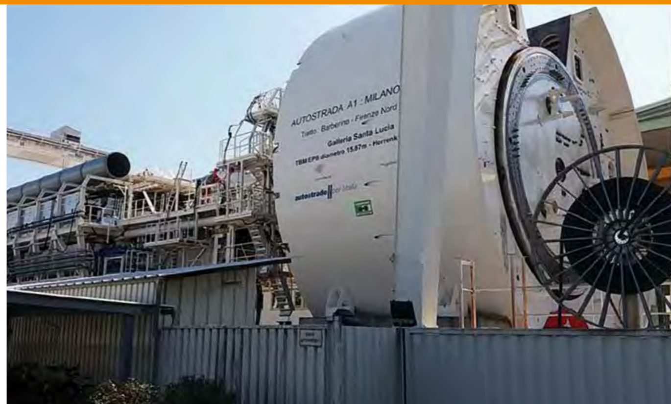
IN ALTO. La talpa TBM-EPB utilizzata per lo scavo: con un diametro di 15,87 m, è la più grande d'Europa.
