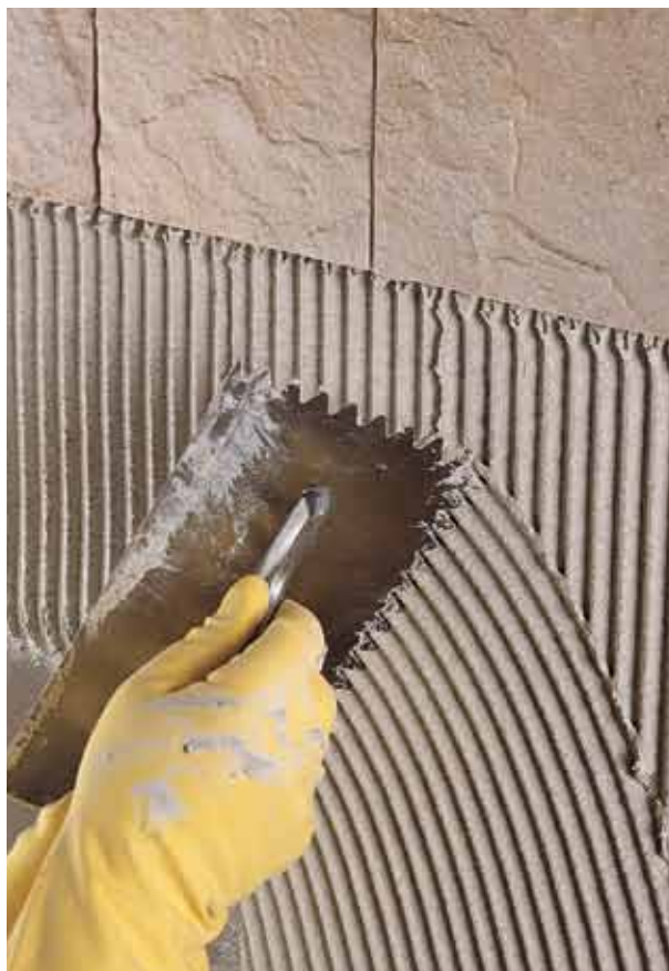
Con l'adesivo cementizio ADESILEX P9 sono state posate piastrelle in ceramica sia in verticale che in orizzontale.
