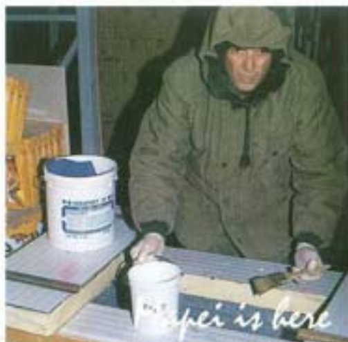
Findus cold storage - Trezzano sul Naviglio (MI) - Italy
